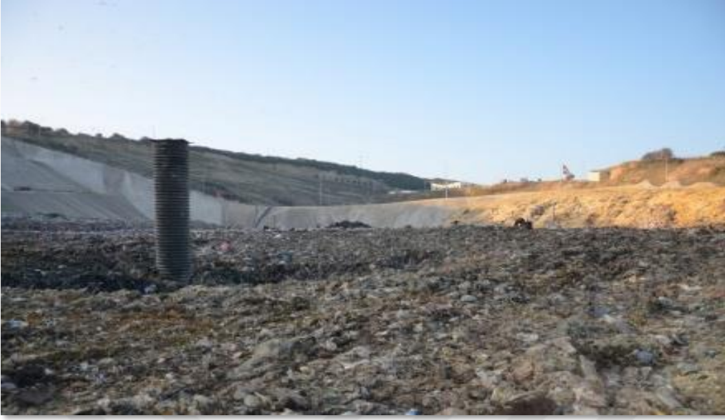
Resim 3.3. Çöp alanı borulaması
