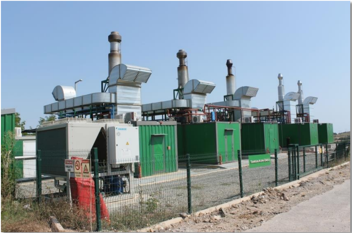
Resim 3.5. Samsun katı atık tesisi elektrik üretim motorları (Çelebi, 2017)
