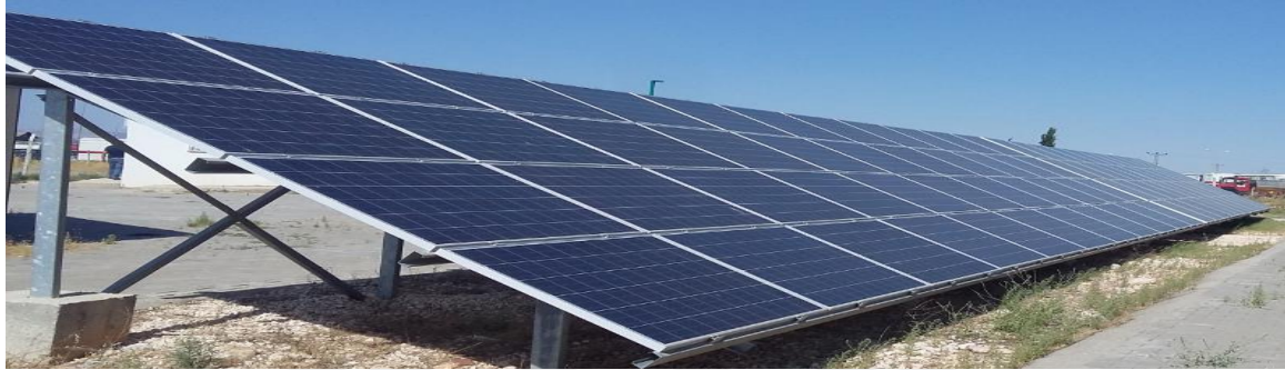
Resim 5.1. Fotovoltaik panellerin genel görünümü
