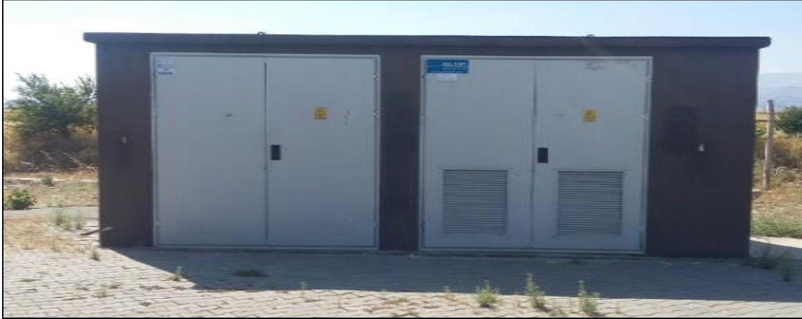
Resim 5.5. 1 MW pano kabini
