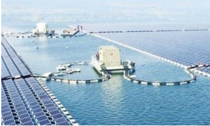
Resim 4.12. Yüzer FV tesisinde kullanılan merkezi evirici görüntüsü
