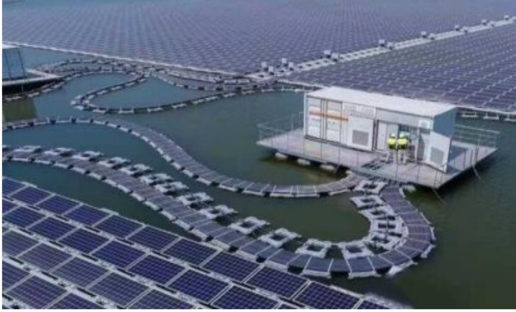
Resim 4.10. Yüzer FV panellerden merkezi evirici köşküne giden DC kablo tesisatı örneği
