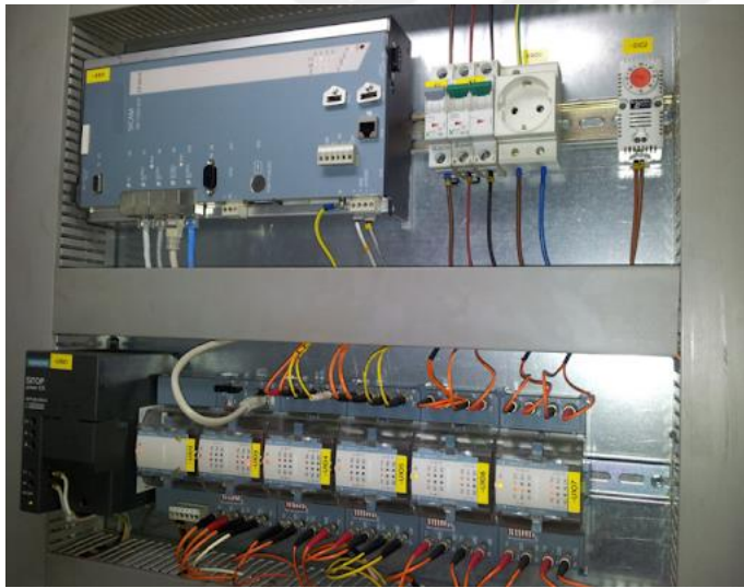
Őekil 6.13. RTU panosu bileşenleri ve pano iç tasarımı örneęi.
